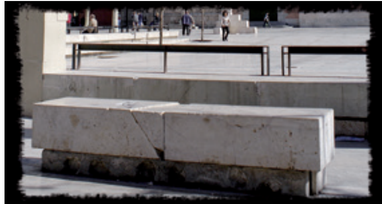
El deterioro era más que evidente
