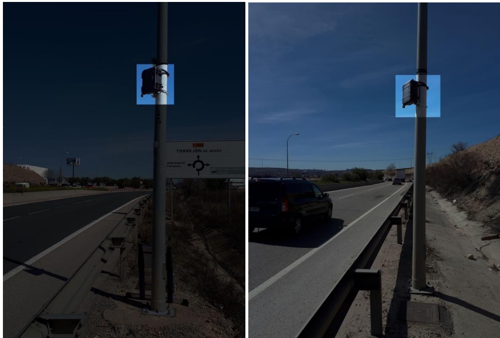
Imagen 6. Aforo automático de tecnología radar ubicado en carretera M-206.
